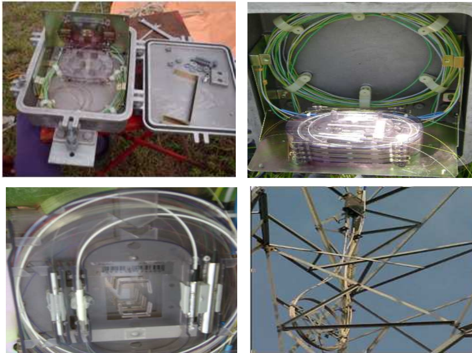
Figura 4.8 – Ilustração de acondicionamento dos pós e pré - amplificadores em caixa de emenda óptica; e instalados nas torres de transmissão.
